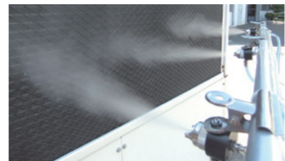
節電対策としての冷却用途例 (配管はお客様施工です) Example: Cooling for energy saving (Customer piping)
